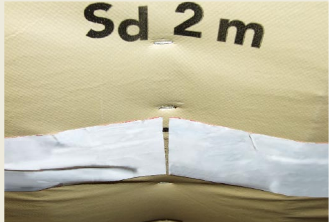
Dicht machen. Nach Einschneiden des Klebebandes erkennt man das Ausmaß der Dehnung. Dieser Bereich muss neu überklebt werden.
