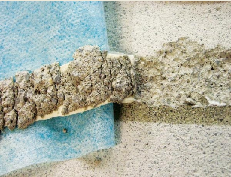
Nicht tragfähig. Der Zusammenhalt der Oberfläche dieses mineralischen Untergrunds ist geringer als die Haftkraft des Klebemittels. Ähnliche Probleme treten auch bei verschmutzten Oberflächen auf.
