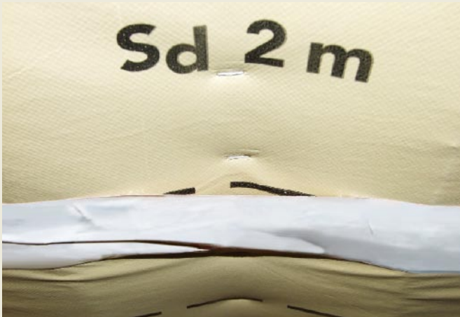
Nicht dicht. Infolge eines Durchhangs der Zwischensparrendämmung hat sich im Bereich des Sparrens das Klebeband abgelöst.
